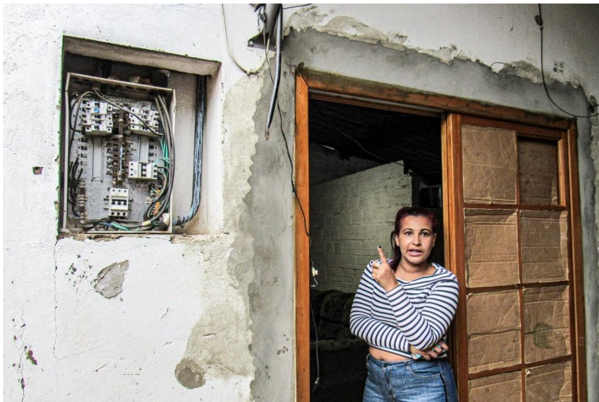
Rede elétrica precarizada na casa de Passagem. - Fotos: Gilnei J. O. da Silva/Coletivo Cidade Mais Humana (2019)
